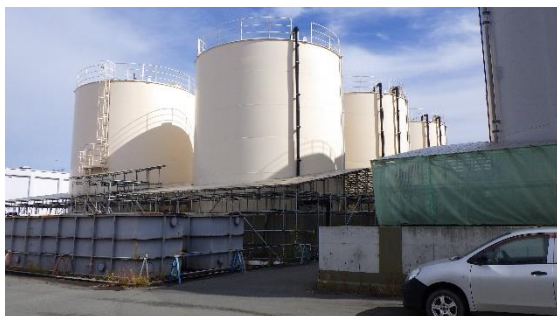
(写真1) 増設・高性能ALPSサンプルタンク外観 (南西側から撮影) ※全6基中3基が高性能ALPSサンプルタンク
