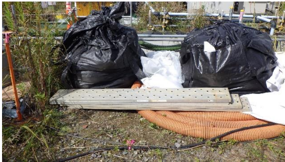
(写真4-1) ゼオライトが入ったフレキシブルコ ンテナの仮置状況 (南側から撮影)
