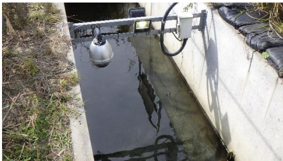
(写真3-2) 物揚場排水路の清掃状況 (下流側から撮影) ※堆積物が除去されて水路底盤の コンクリート面が確認できた。
