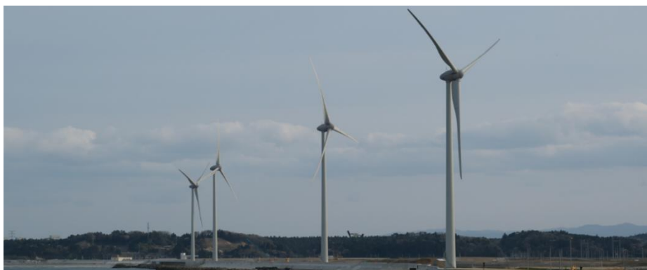
図：万葉の里風力発電所（南相馬市）（提供：㈱南相馬サステナジー）
