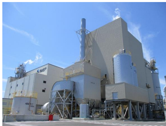
写真：エア・ウォーター&エネルギー・パワー小名浜バイオマス発電所 (2021年4月営業運転開始) (提供：エア・ウォーター(株))
