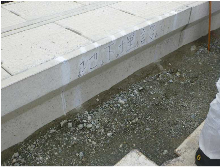
○地下埋設物があることを示す表示（ケーブル損傷後に応急的に表示している） （建屋止水対策工事現場）
