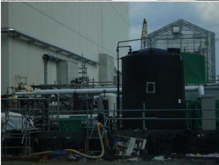
○除染装置廃スラッジ 保管施設 排気設備
