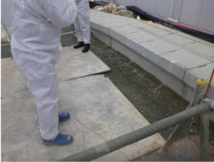
○掘削により埋設ケーブルを損傷させた箇所 (建屋止水対策工事現場)
