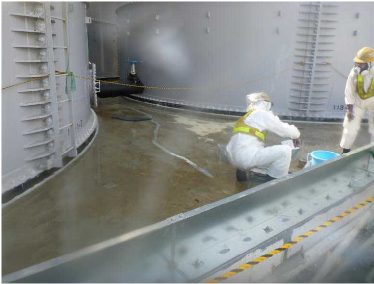
○ H5 タンクエリア コンクリートのひび割れ 箇所の塗装後の状態
