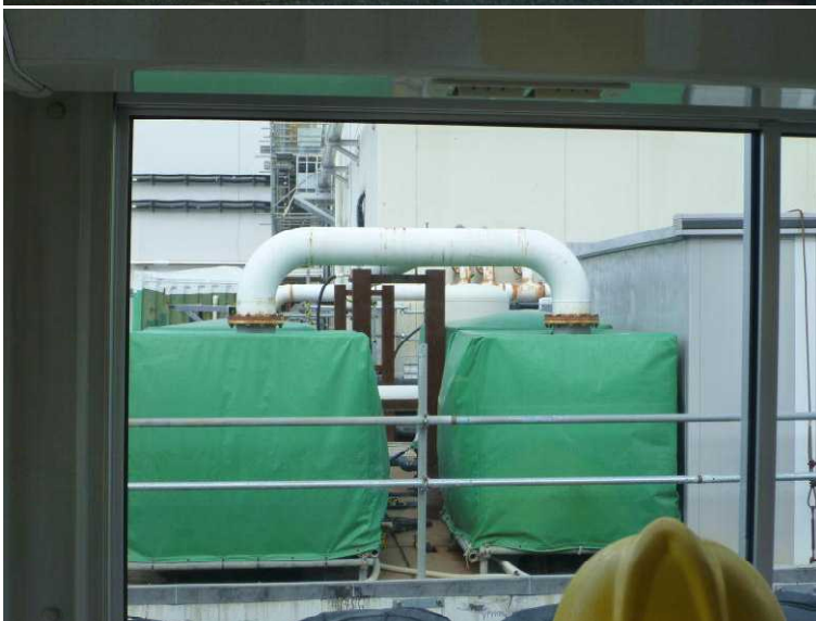
○除染装置廃スラッジ 保管施設 排気設備
