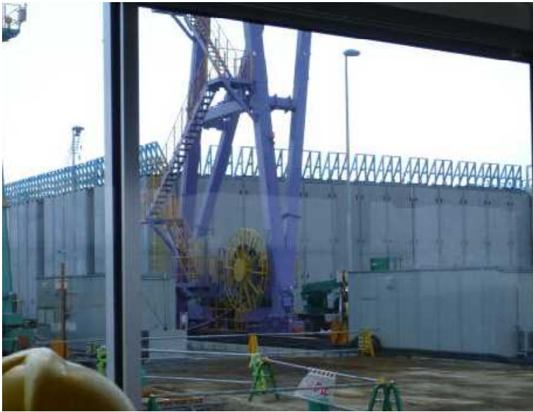
○使用済セシウム吸着塔 一時保管施設 (第三施設)
