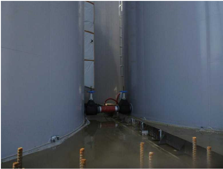
○ J1 タンクエリア タンク連絡弁の状況
