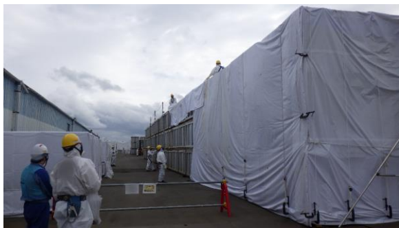
(写真 2 - 2) 仮設集積場所における仮設シート養生作業の状況
