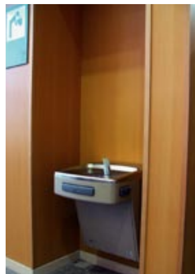
子供や車いす使用者の利用にも配慮した水飲み場 (公立藤田総合病院)
