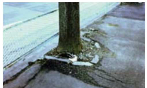
根が張り、舗装を持ち上げている例
