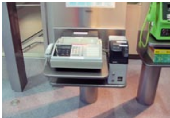
電話機に隣接してFAXを設置した例（福島空港）
