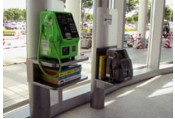
子供や車いす使用者の利用にも配慮した電話台（福島空港）
