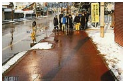
歩道に消融雪施設を設けた例
