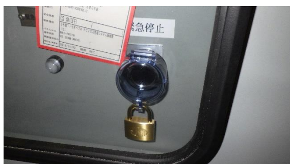
(写真 3) 緊急停止ボタンカバーへの鍵の取り付け状況
