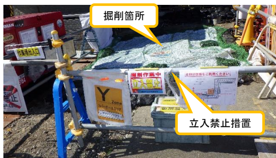
(写真2) 立入禁止措置の状況
