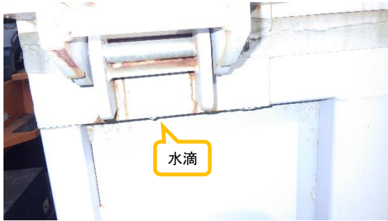
(写真1-3) 舗装面(地面)に滴下する水の状況 (南西側から撮影)
