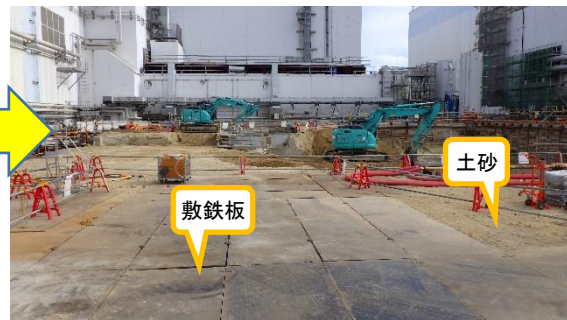
(写真2-2) 土砂による埋め戻しの状況① (西側から撮影(11月8日))
