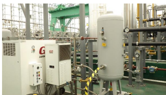
(写真 3) 機器の状況 (コンプレッサは稼働中)
