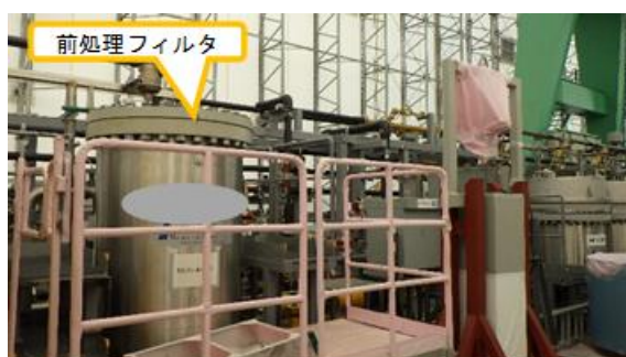
(写真 2 - 3) 前処理設備の状況
