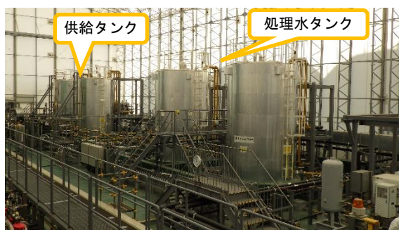
(写真 2 - 2) 処理水タンク等の設置状況
