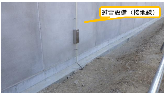
(写真 5 - 1) 避雷設備の設置状況
