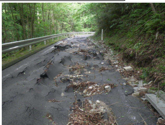
【被災状況 林道崩壊】
