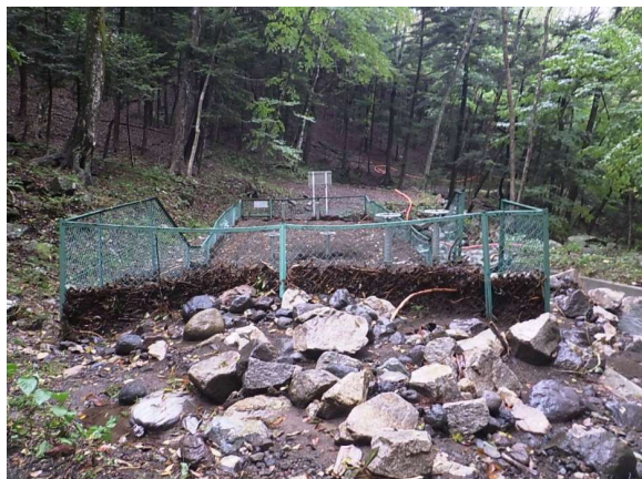
【被災状況 土砂流入】
