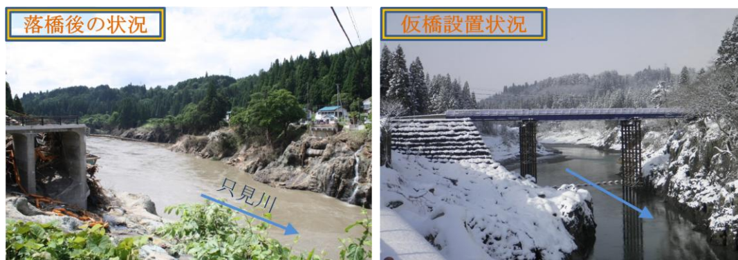
【写真5. 13】二本木橋落橋(左)及び仮橋架橋状況(右)
