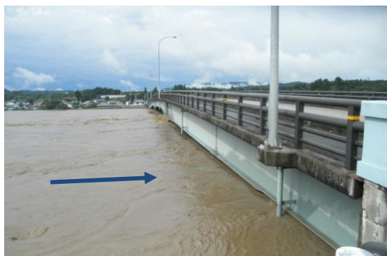
③ 会津坂下町片門地区増水状況
