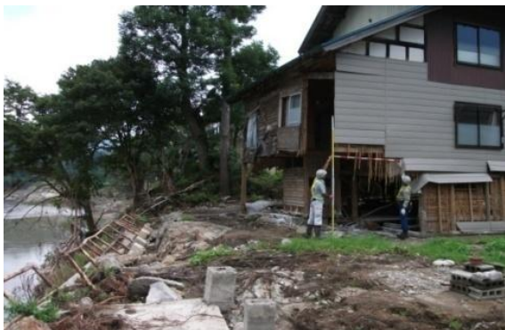
⑤ 金山町横田浜子地区被害状況
