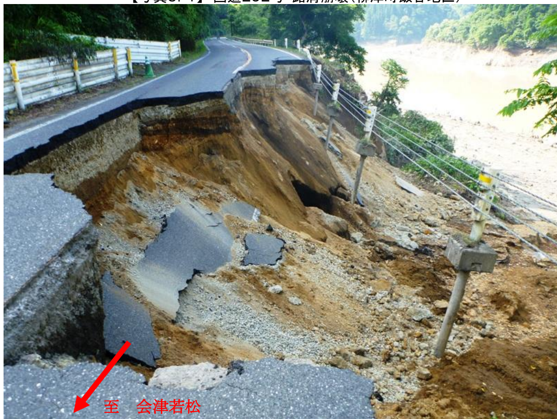
【写真3. 1】 国道252号 路肩崩壊(柳津町飯谷地区)
