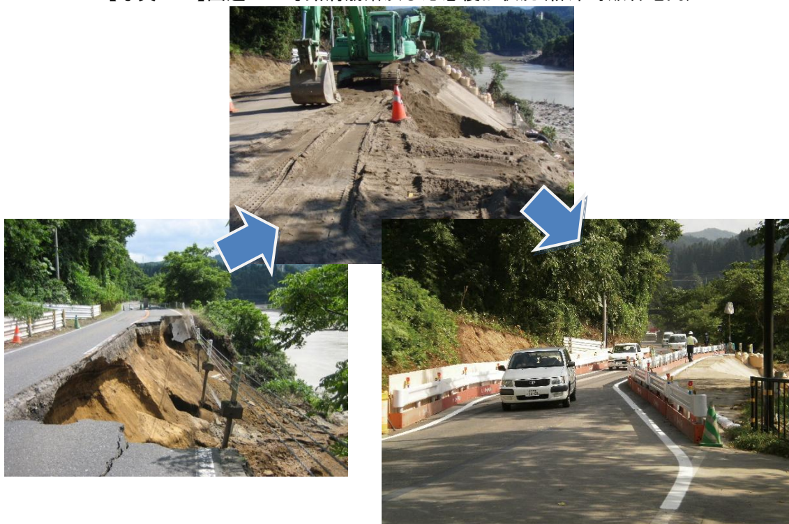
【写真4. 5】国道252号路肩崩落及び応急復旧状況(柳津町飯谷地内)
