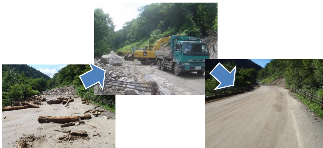
【写真4. 9】国道352号(錦秋橋付近)土砂流出・復旧状況
