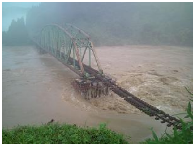
【写真1. 1】JR只見線 第5只見川橋梁流出
