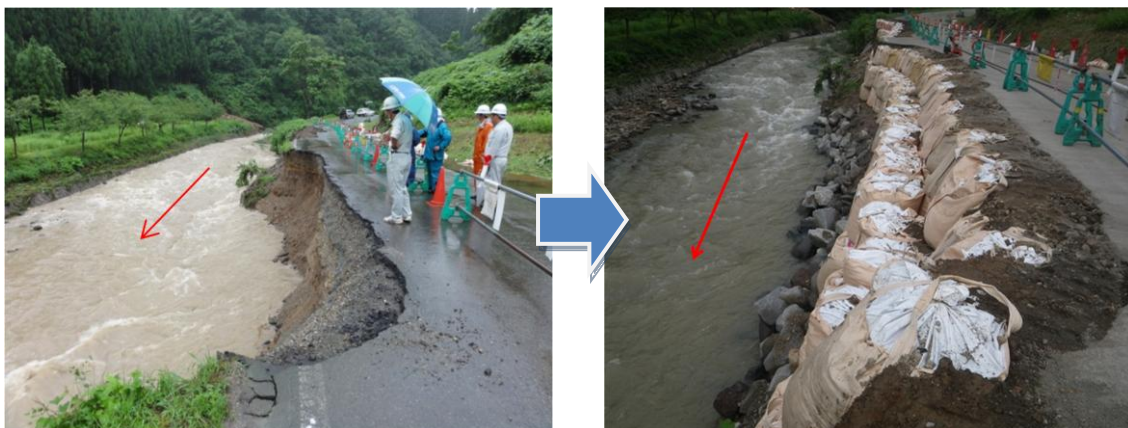
【写真4. 6】国道400号路肩崩壊及び応急復旧状況(西会津町下谷地区)
