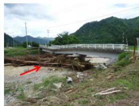
国道289号 花立橋(只見町) 【新潟・福島豪雨による橋梁損壊】
