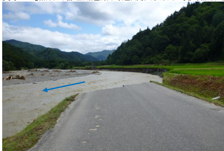
【写真3. 8】黒谷川管理用通路（町道）流出状況（只見町黒谷地内）
