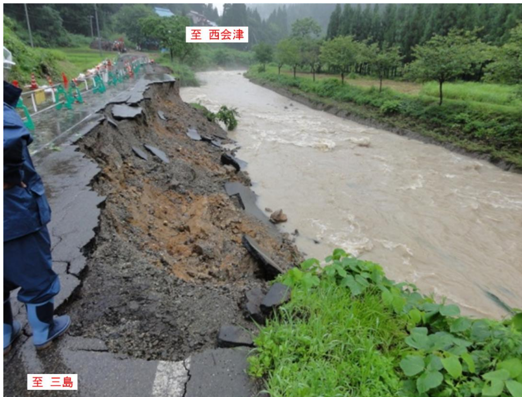
【写真3. 3】 国道400号路肩崩壊(西会津町下谷地区)
