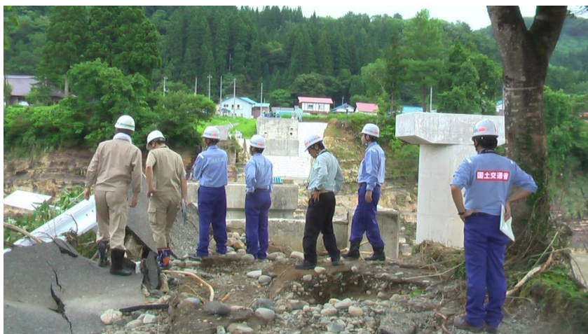
被災状況調査(金山町)
