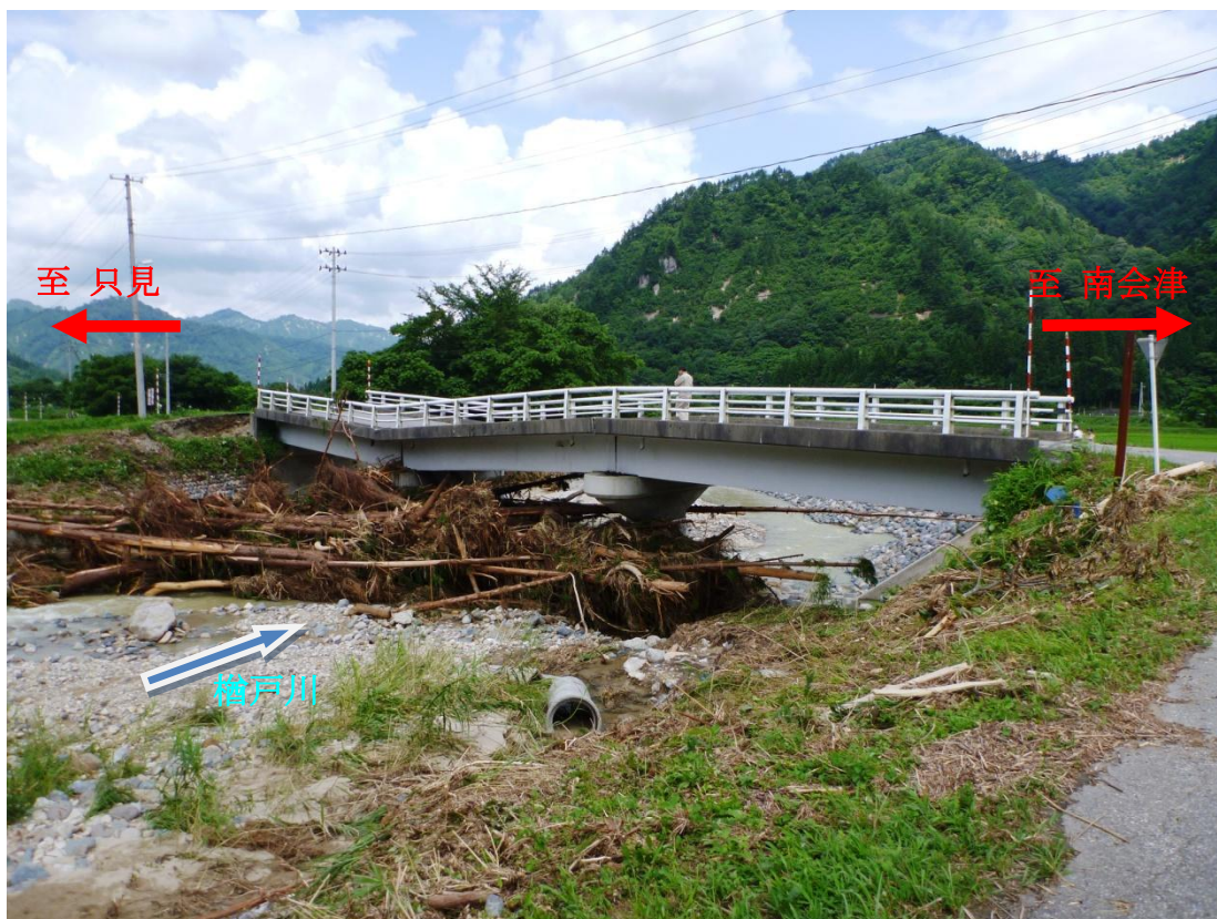
【写真3. 2】 国道289号花立橋 橋脚沈下(只見町榎戸地区)
