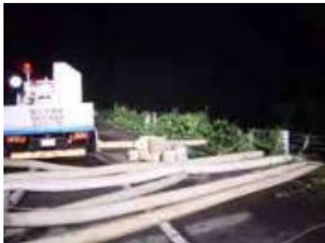
排水ポンプによる強制排水(会津坂下町)
