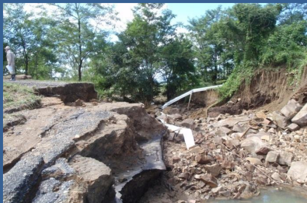
破堤箇所（玉川村中地内）
