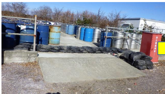
(写真2-1) 前回の搬入用スロープの土嚢による 仮堰の状況 (令和4年1月19日撮影)
