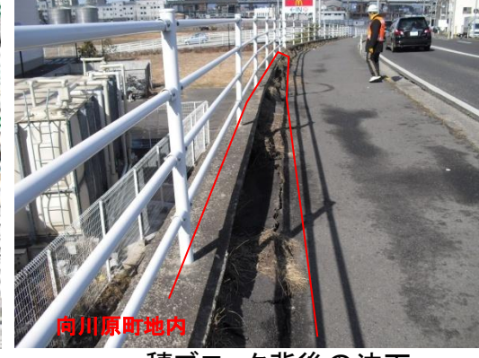
積ブロック背後の沈下
