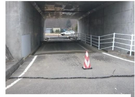
液状化によるボックスカルバートの沈下
