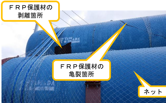
(写真4) FRP保護材の亀裂、剥離の例 (エリア北東側を北側から撮影)
