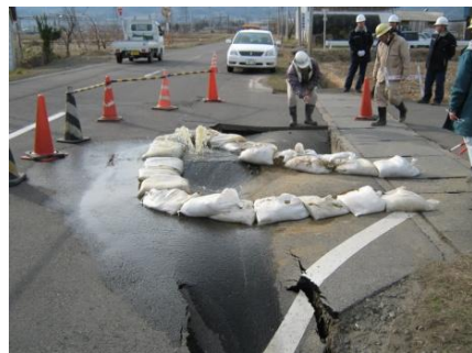
汚水の溢水状況
