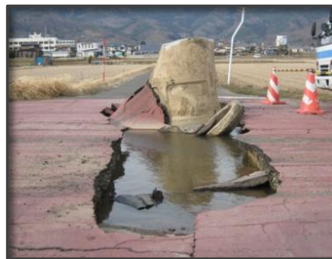
被災状況(H23.3)
