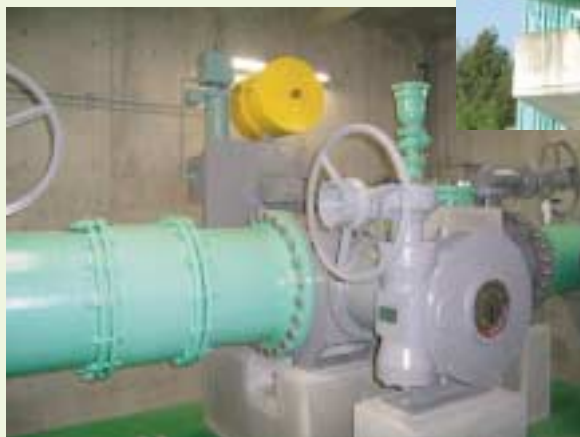
緊急遮断弁 (平野緊急遮断弁 Φ=1,100)
