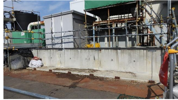
(写真3-2) 仮置きされた被覆材は撤去されていた
