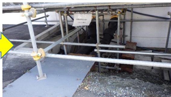
(写真1-2) 焼却工作建屋西側陥没箇所①の状況 (今回(3月24日)撮影)
