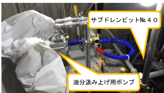
(写真 3-2) 油分回収用の汲み上げポンプ
