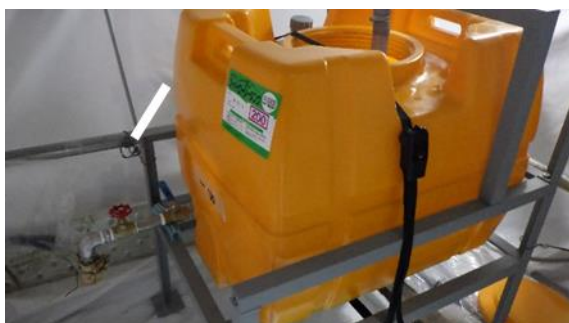
(写真 3-3) 回収した油分貯留用の仮設ローリー タンク
