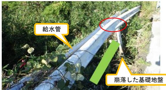
(写真2-1) ガードレールの歪曲と基礎地盤崩落 の状況 ガードレールの赤丸部分に歪曲が生 じている
