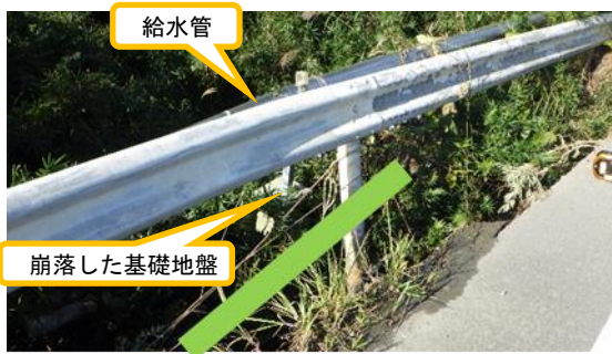
(写真2-2) 給水管の基礎地盤崩落の状況
