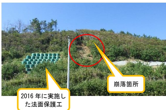
(写真1-1) 崩落箇所の状況(東側から撮影)(令和元年10月16日撮影)
