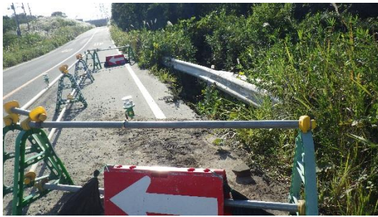
(写真7-1) 崩落箇所の状況(北東側から撮影) (令和元年10月15日撮影)
