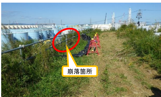
(写真5-1) 崩落箇所の状況(エリア 西側法面。法面上側から撮影。) (令和元年10月16日撮影)
