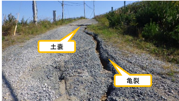
(写真6-1) 進入道路の亀裂の状況(進入道路北側を下側から撮影) (令和元年10月16日撮影)
