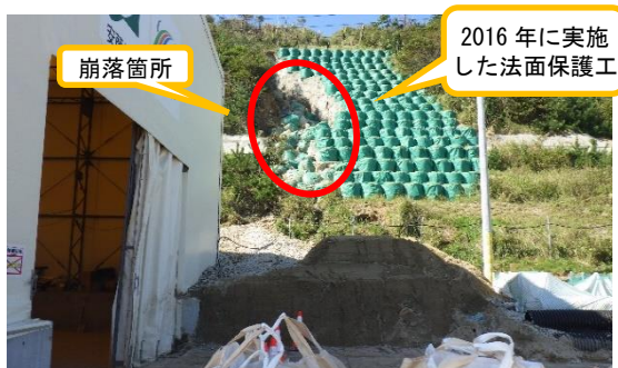
(写真2-1) 崩落箇所の状況(東側から撮影)(令和元年10月16日撮影)
