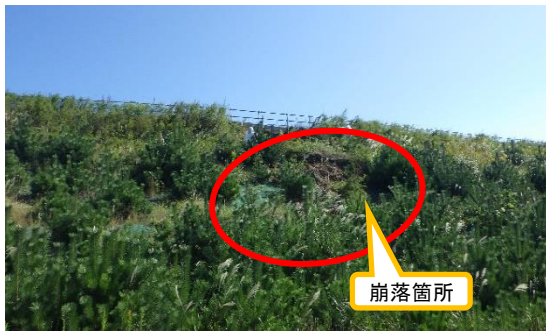
(写真4-1) 崩落箇所の状況(エリア 西側法面。法面下側から撮影。) (令和元年10月16日撮影)
