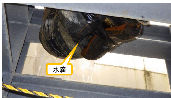
(写真3) 漏えいの状況 (写真2 配管下部)
