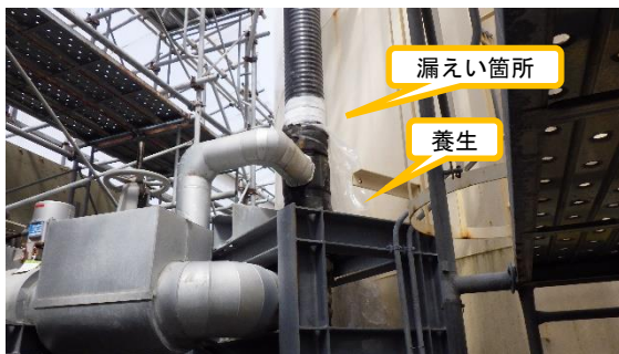
(写真2) 漏えいが確認された接続管の状況 (西側から撮影)
