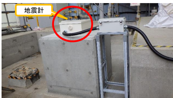
(写真1-2) 地震計の設置状況② (南西側から撮影) ※赤丸印のケースの中に2台の地震計 が収納されている。
