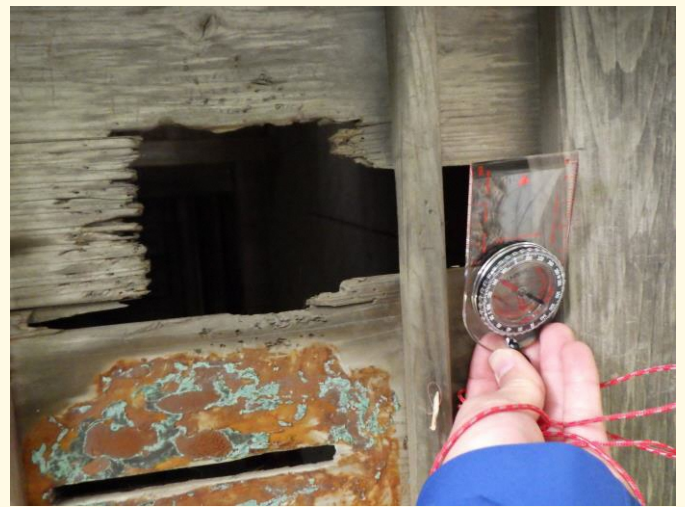
アライグマが侵入できる壁の破損
