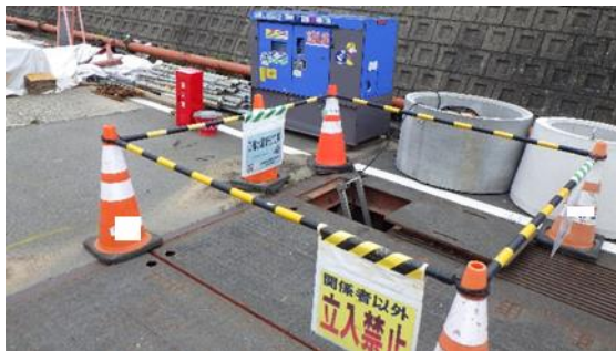
(写真2-1) 上流側到達立坑地上部の状況① (南東側から撮影)
