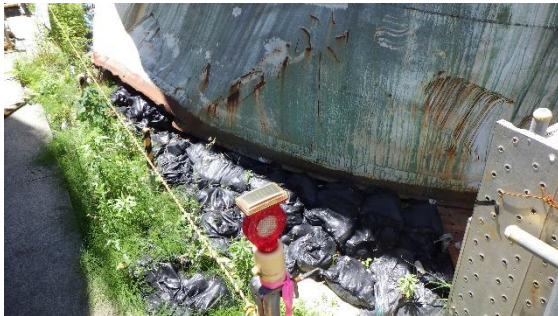
(写真2) No. 1重油タンク下部の状況
