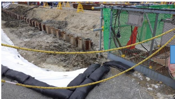
(写真 2 - 1) 上流水槽設置予定地の状況 (令和 4 年 6 月 17 日 撮影) (北東側から撮影)
