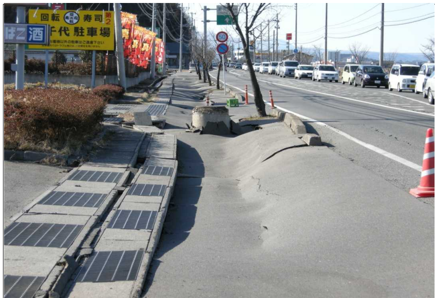
写真5-1 白河市 管路損傷に伴う道路の陥没及びマンホール浮上
