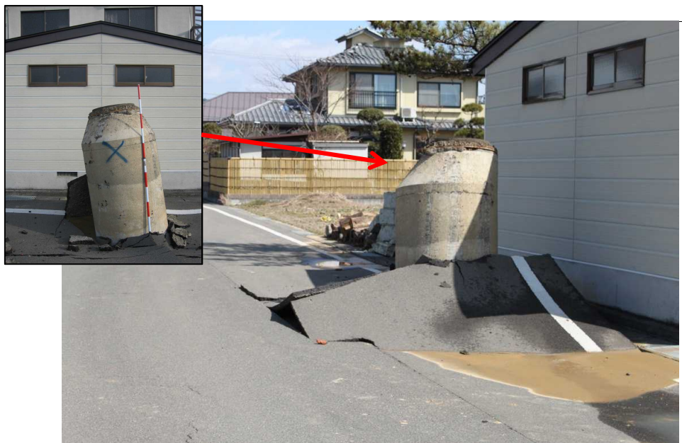
写真6-1 国見町 液状化によるマンホール隆起
