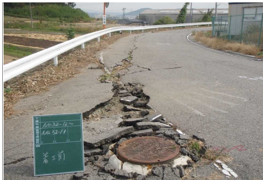
写真4-1 本宮市 管路損傷に伴う道路の陥没及びマンホール浮上
