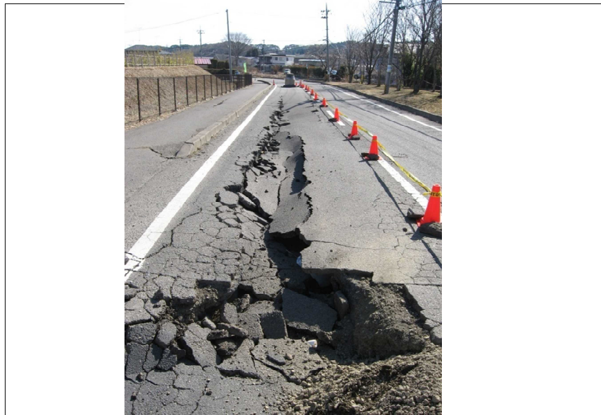
写真1-1 西郷村 管路損傷に伴う道路の陥没
