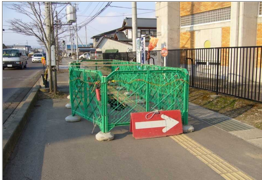
写真2-1 喜多方市 管路損傷に伴う道路の陥没
