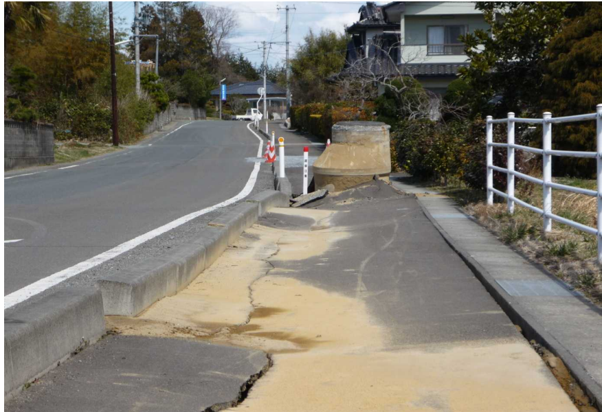
写真7-1 新地町 管路損傷に伴う道路の陥没及びマンホール浮上
