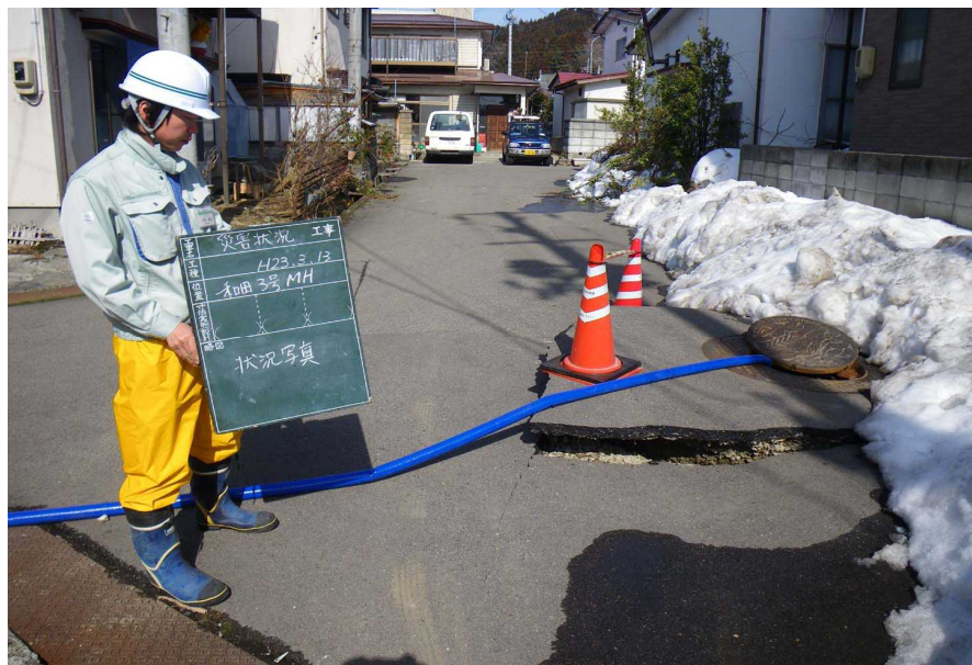
写真3-1 会津若松市 マンホールポンプ被災状況
