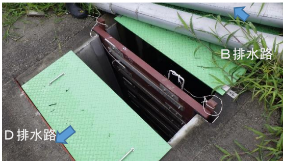
(写真1-1) B排水路とD排水路接続部に設置されていた排水路仕切 (図1①)
