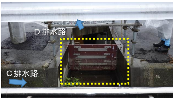
(写真1-2) C排水路とD排水路接続部に設置されていた排水路仕切
