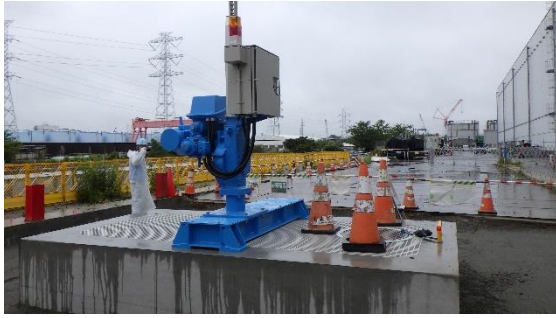
(写真4-3) 両発進立坑跡地付近におけるゲート 地上部（東側から撮影）
