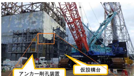
(写真1-1) 1号機原子炉建屋周辺の状況
