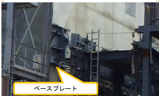
(写真1-2) 1号機原子炉建屋西壁ベースプレートの状況 ※ (写真1-1) の拡大図
