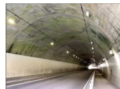
LED化したトンネル照明
