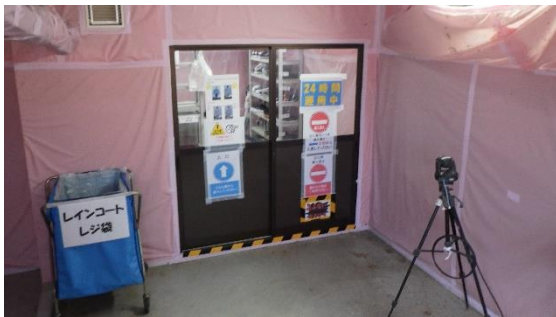
(写真6-2) 1, 2号サービス建屋に設置されている給水所の入口
