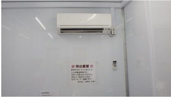
(写真4-3) Bタンクエリア西側に設置されている給水所の内部② エアコンが設置されている。
