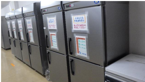
(写真 2-4) 入退城管理棟内に常備されている保 冷剤を冷やす冷凍庫
