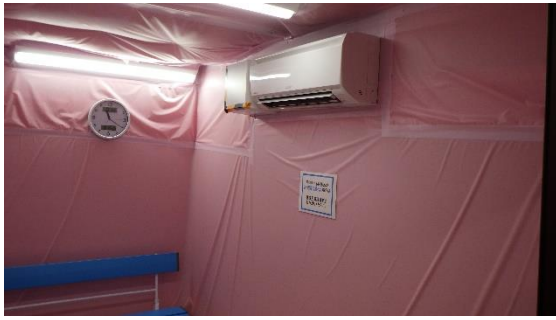
(写真6-4) 1, 2号サービス建屋に設置されている給水所の内部② エアコンが設置されている。
