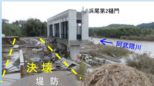
98.6k 左岸堤防決壊箇所(須賀川市)
