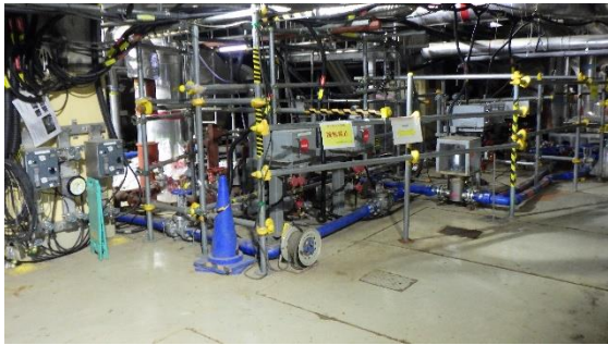
(写真1-1) 1号機タービン建屋内炉注水ポンプの概観
