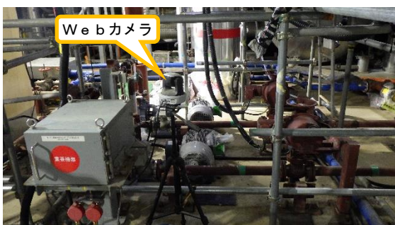
(写真3) Webカメラの設置状況
