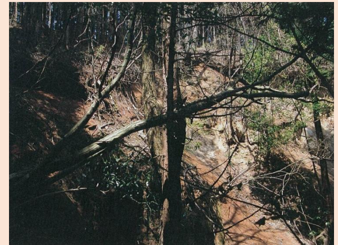
斜面崩壊状況
