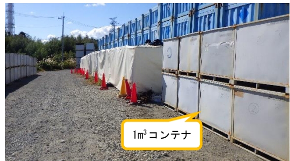
(写真1-4) ノッチタンクが設置されていた箇所の状況 (令和4年10月31日北側から撮影)
