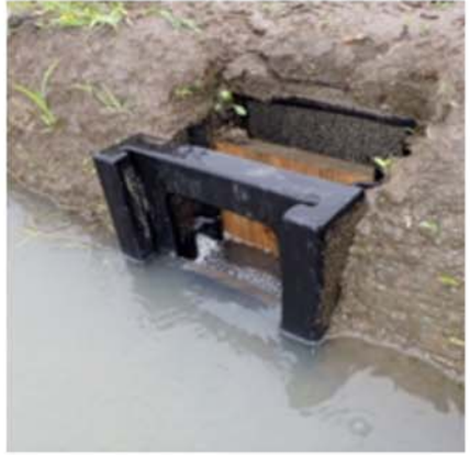
①排水柵(機能分離型) ②排水柵からの排水状況
