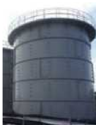
フランジ型タンク
