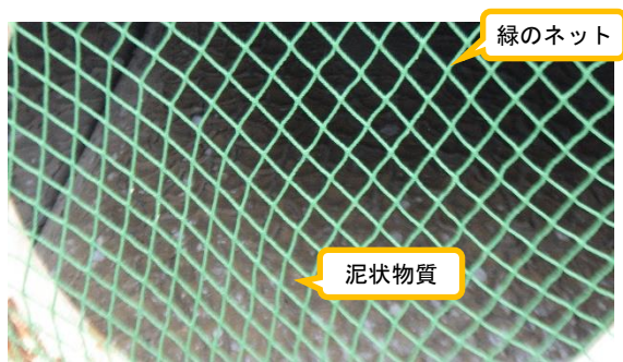
(写真3-2) J群タンクのマンホール内の状況
