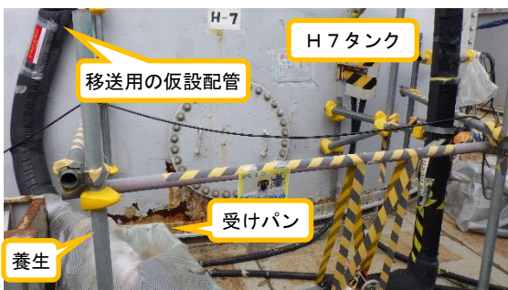
(写真2-3) H・I群タンク間に設置された内包水移送用の仮設配管の例② ※写真はH7タンクからI7への移送用
