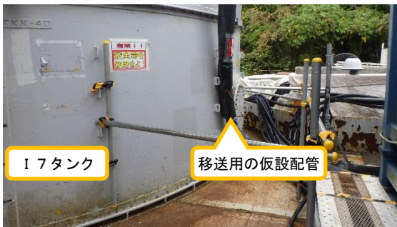
(写真2-2) H・I群タンク間に設置された内包水移送用の仮設配管の例① ※写真はH7タンクからI7への移送用
