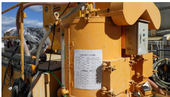
(写真3-1) 薬液注入工事用機材の設置状況②(粒子の粗い薬液を注入。)
