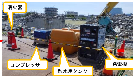
(写真 2 - 2) H 9 (西) タンクエリアコンクリート構造物破砕作業ヤードの状況② (令和 4 年 8 月 1 日撮影)
