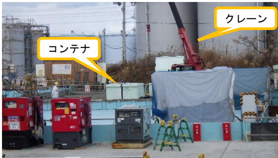
(写真4-2) Eタンクエリア（追設一時保管エリアE E 2設置予定）の状況②
