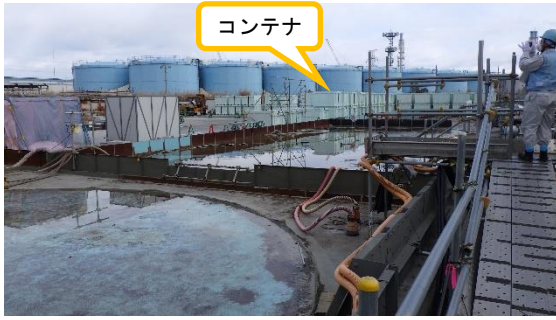
(写真4-1) Eタンクエリア（追設一時保管エリアE E 2設置予定）の状況①
