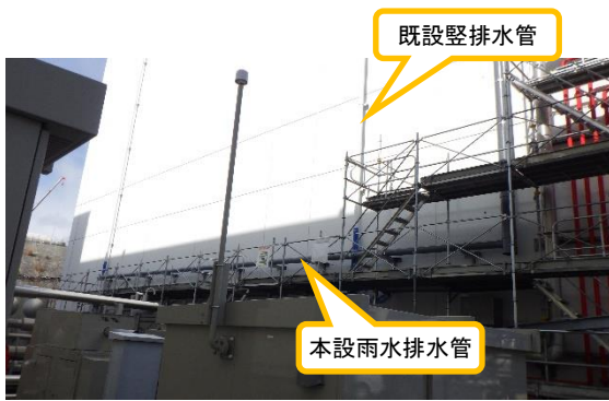
(写真 2 - 2) 共用プール建屋南壁の本設雨水排水 管の設置状況 (南東側から撮影)
