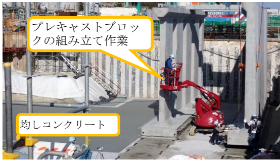
(写真3-3) 放水立坑（上流水槽）の構築工事の状況③ (南側から撮影)
