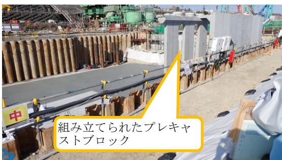
(写真3-2) 放水立坑 (上流水槽) の構築工事の 状況② (東側から撮影)
