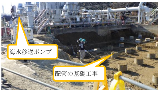
(写真4) 海水移送ポンプと海水配管ヘッドを繋ぐ配管の基礎工事 (北東側から撮影)
