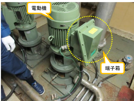
(写真2) サンプルポンプ (A) 電動機の状態
