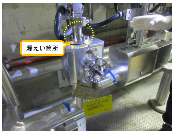
(写真4) 高電導度廃液系の加熱器（B）凝縮 水導電率計の状況
