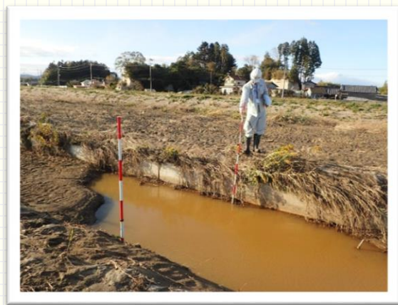
↑台風災害後の調査の様子
