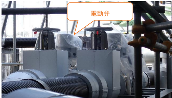
(写真 3) 電動弁の様子
