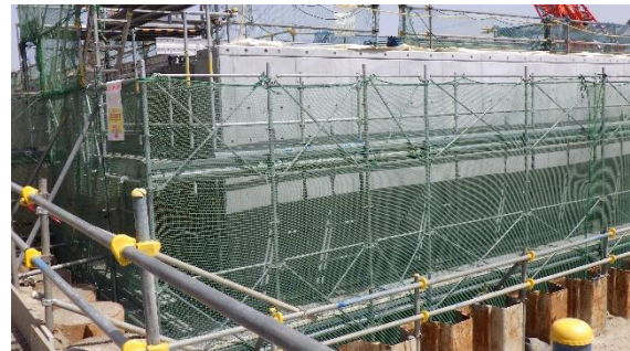
(写真4-2) 放水立坑（上流水槽）の状況（今回 （令和5年4月13日）南西側から撮影）
